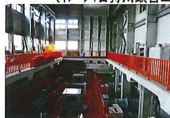
(イメージ;川南揚水機場)
